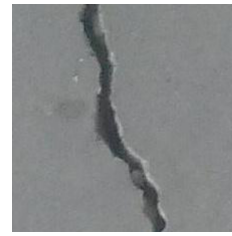
Figura 2: Imagem de rachadura.
