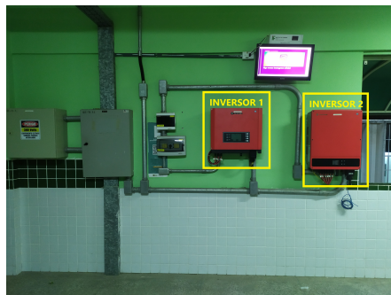
Figura 2: Sistema de gerenciamento elétrico dos inversores responsáveis pela geração fotovoltaica no IFCE Maracanaú.
